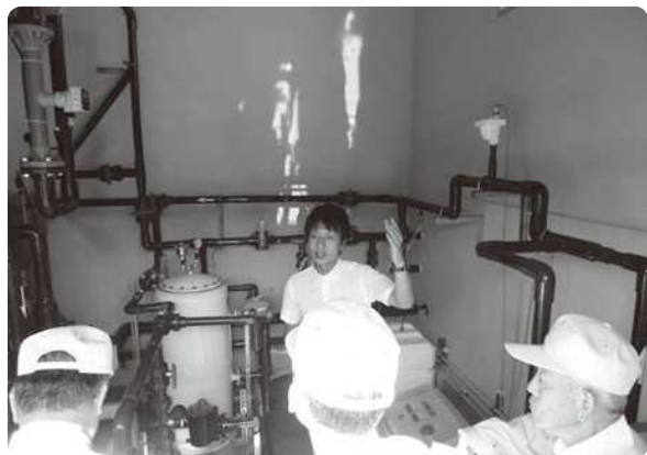
南越前ダイビングパーク（濾過器設備）
